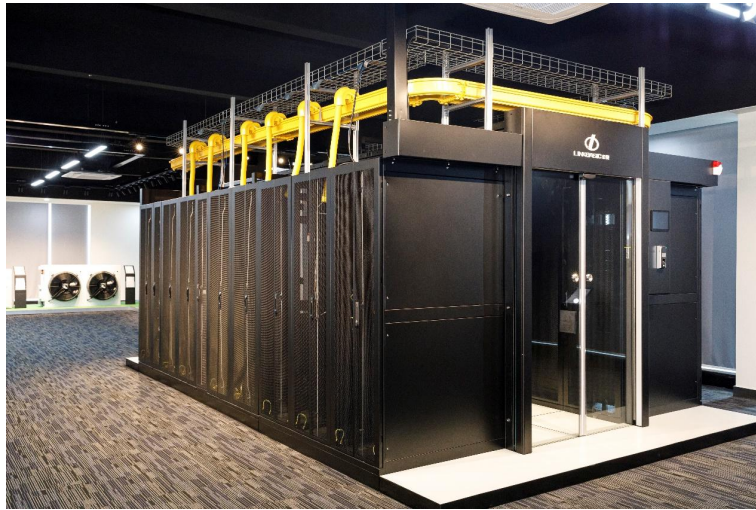
M1 系列微模块数据中心
